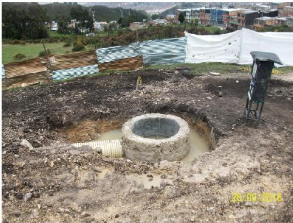
Fotografía 8. Punto de intervención del pozo de alcantarillado residual, desde el cual la constructora informó que se adelantaría la instalación de la tubería por medio de perforación dirigida, bajo el cauce de la quebrada San Camilo.
