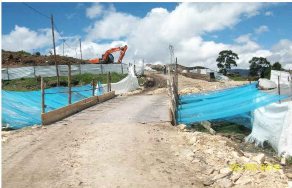
Fotografía 1. Punto de intervención de la quebrada San Camilo, mediante la construcción de un puente provisional, proyecto urbanístico "MIRADOR DEL ESTE" .
