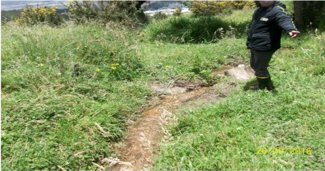
Fotografía 5. Punto de intervención del box culvert No. 2, para el acceso al proyecto urbanístico "MIRADOR DEL ESTE".
